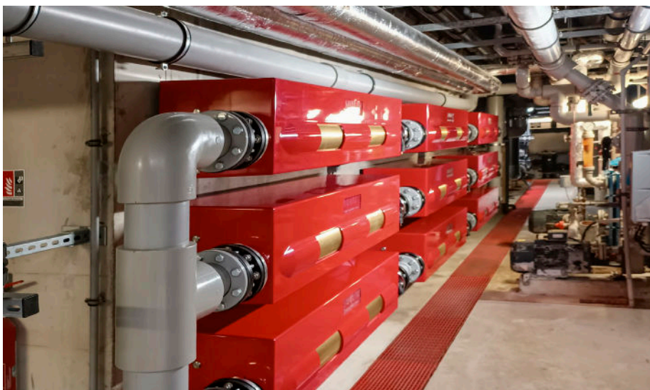
Exemple d'installation d'une centrale Hyperionique « Sublio » destinée à la montée en Hyperionicité de l'eau des soins thérapeutiques dans un centre thermal.
